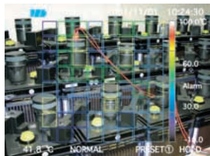
■ UPS、バッテリーのメンテナンス。
