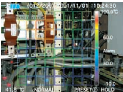
■ 変電設備、配電盤のメンテナンス。
