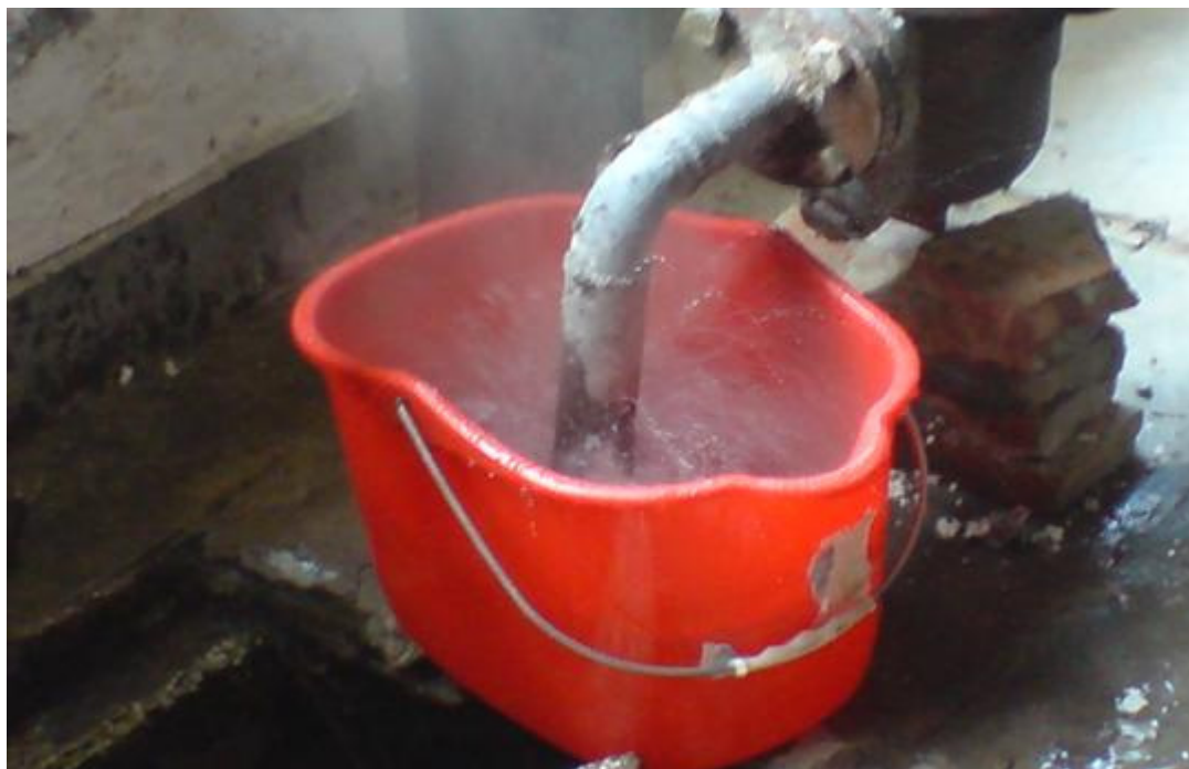
被传统疏水阀强烈喷出的蒸汽冲起的水
